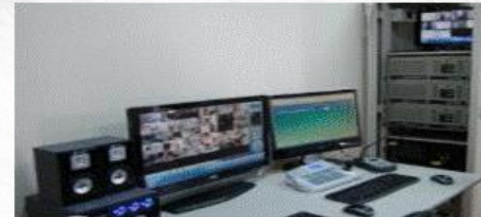
高品質影音設備 及中央控制室
